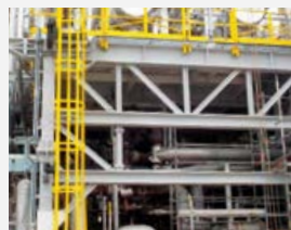
Protección pasiva contra el fuego
